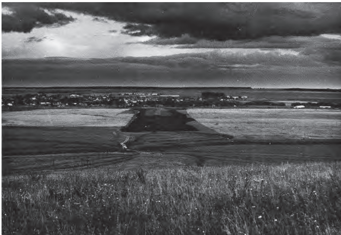
Рис. 2. Золотоордынский Биляр – Билярское III селище, центральная часть, июль 1994 г. Строительный котлован дороги. Вид с севера с горы Балынгуз.
