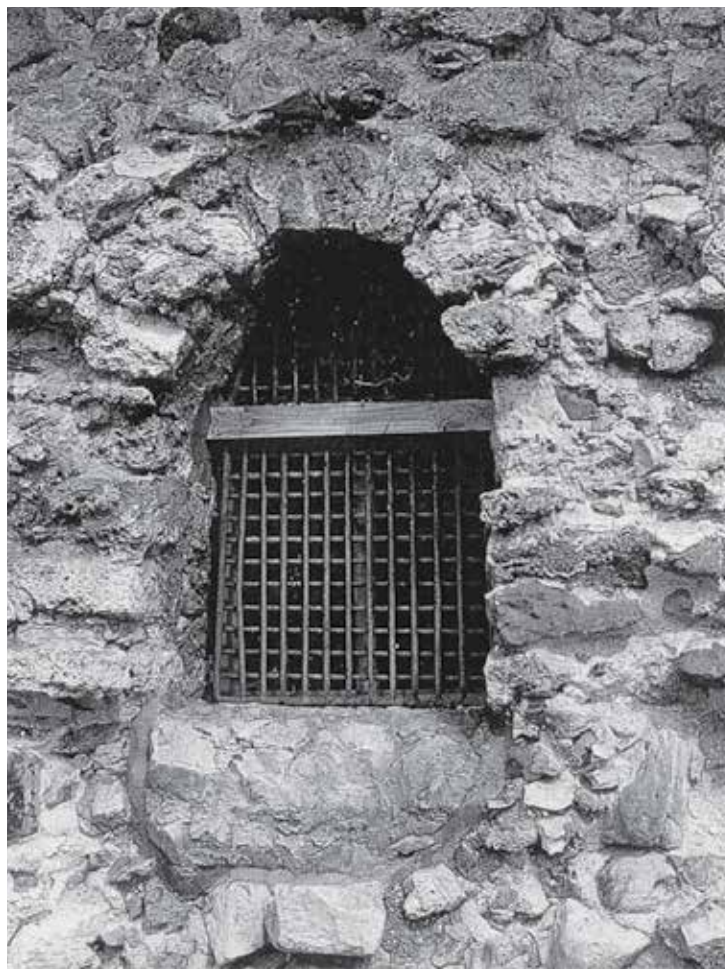
Рис. 219. Фрагмент западного фасада Северного мавзолея после консервации и фрагмент реставрации. Начало 1970-х гг.
