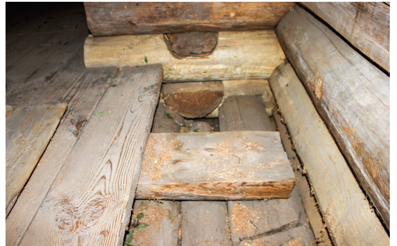
Рис. 66. Конструкция надподвального перекрытия. «Черный» и «чистый» пол в северо-западном углу кафоликона. Фото 2015 г.
