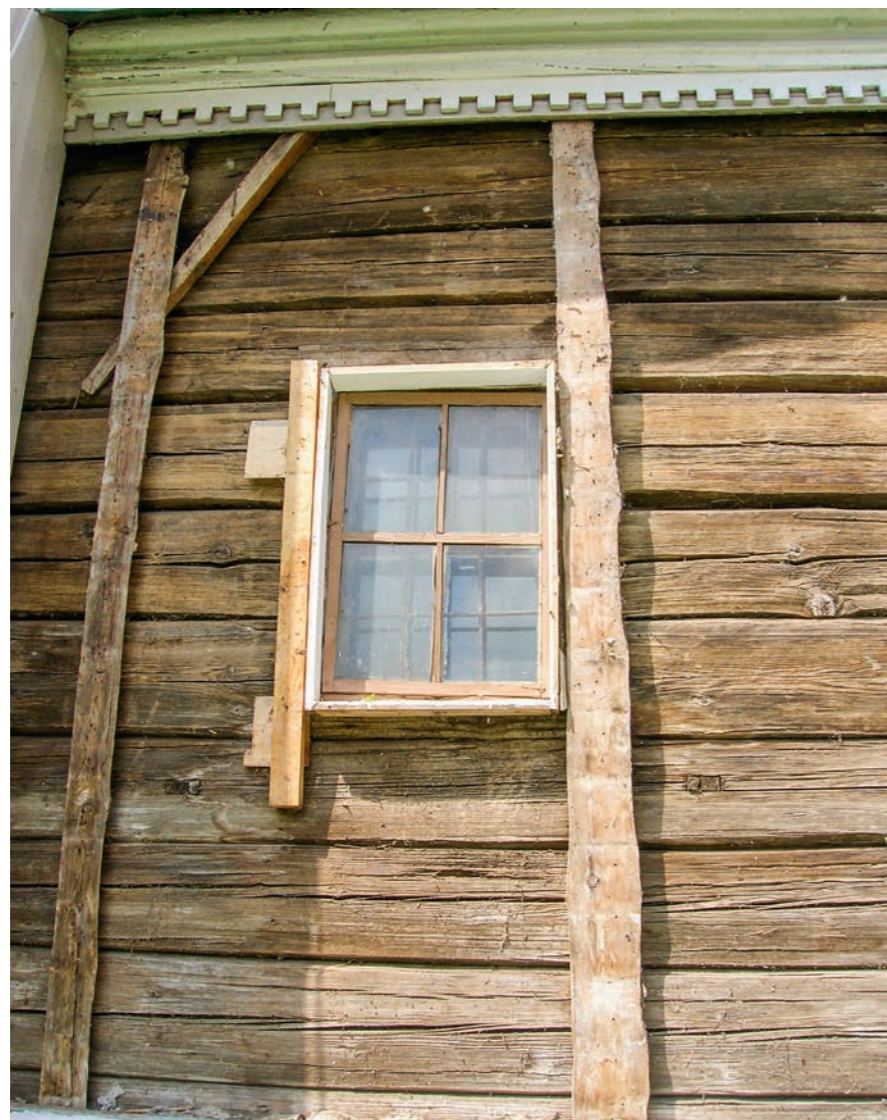
Рис. 40. Гнезда с остатками опор-«пальцев» конструкции строительных подмостей под южным окном алтаря Троицкой церкви. Фото 2011 г.
