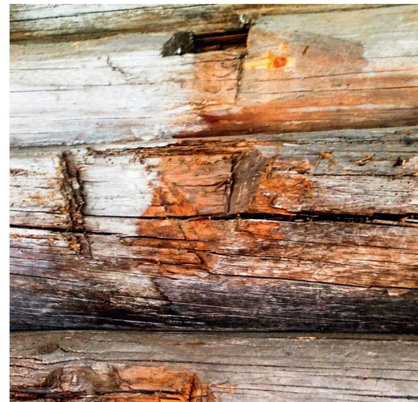
Рис. 91. Следы попытки прорубки второго «красного» окна в кафоликоне. Северная стена. Фото 2011 г.
