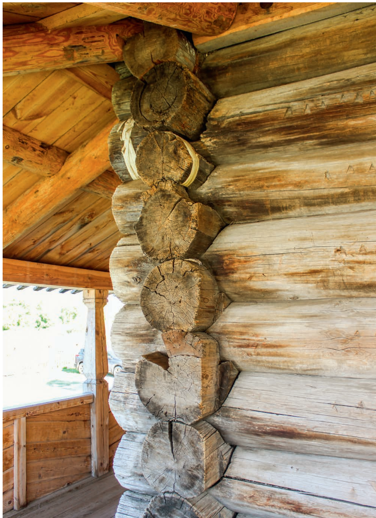
Рис. 108. Подтески для установки стоек паперти на бревнах западной стены трапезной слева от входного проема. Фото 2015 г.
