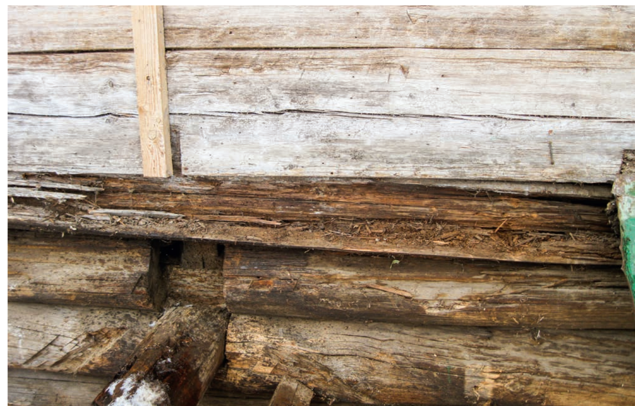
Рис. 55. Разрушенное вниз первоначальное гнездо под коневую слегу крыши алтаря на восточной стене храма. Фото 2011 г.
