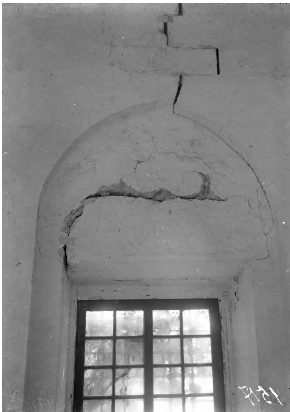
Рис. 622. Бахчисарай. Негатив 1928 г. Ханский мавзолей. Трещина, образовавшаяся в результате землетрясения (Фонды БИКАМЗ. Ф-649).
