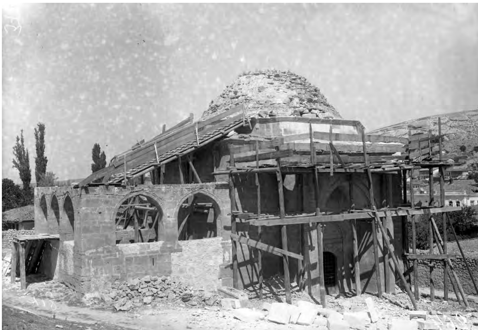
Рис. 587. Бахчисарай. Негатив 1928 г. Эски-Дюрбе. Реставрационные работы, вид с юго-востока (Фонды БИКАМЗ. Ф-614).
