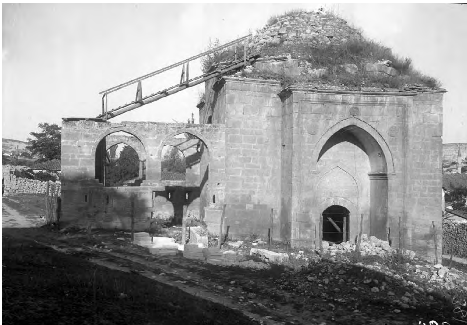
Рис. 589. Бахчисарай. Негатив 1928 г. Эски-Дюрбе. Реставрационные работы, вид с юго-востока (Фонды БИКАМЗ. Ф-617).
