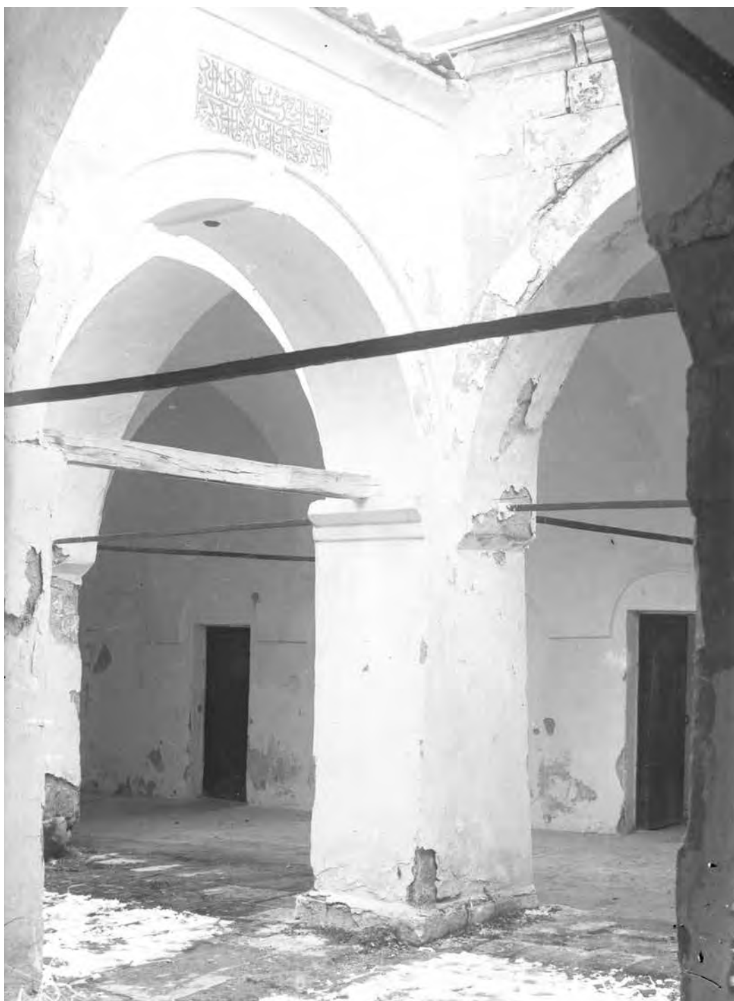
Рис. 625. Бахчисарай. Салачик. Негатив 1928 г. Зинджирлы медресе. Колонны внутреннего двора, вид с северо-востока (Фонды БИКАМЗ. Ф-652).
